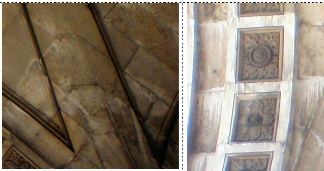
Fig. 4 – Depósitos de escorrência brancos
