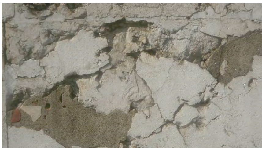
Fig. 8 – Remendos de cimento
