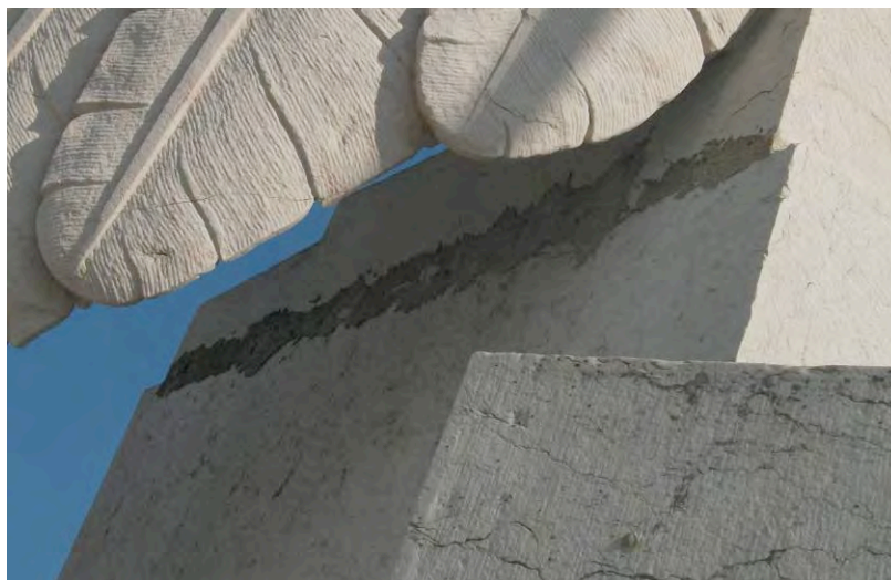
Fig. 6 – Manchas de cimento associadas à colmatação de juntas
